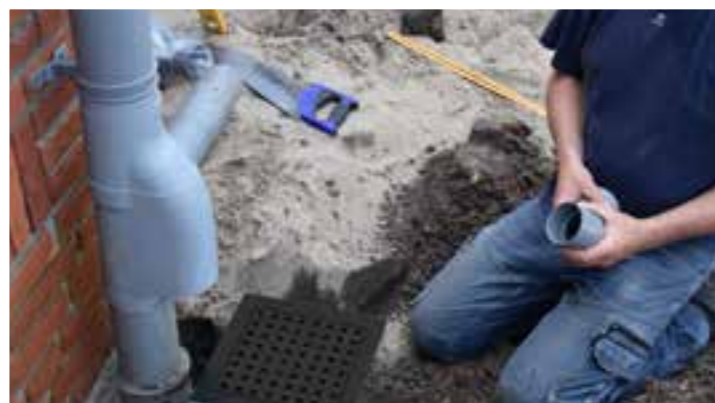
Op de regenpijp wordt een loofscheider gemonteerd, die er voor zorgt dat er geen grof vuil zoals blad in de zandvangput terecht komt.
