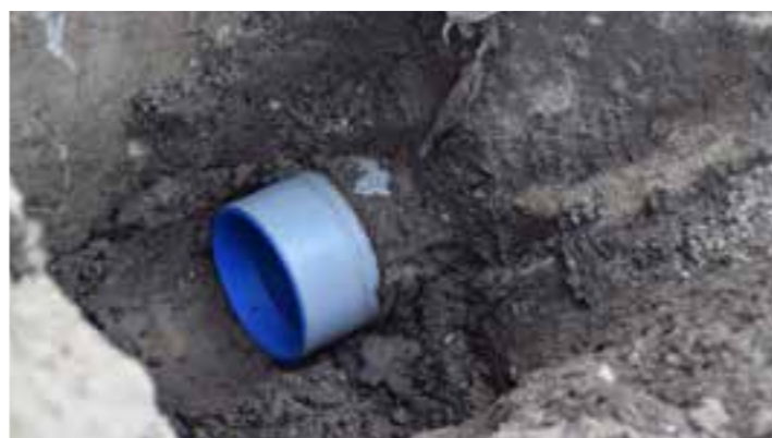
De rioolpijp die nu vrij komt te liggen wordt afgedopt, zodat er geen vuil meer het riool in loopt.
