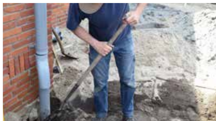
De regenpijp van het dak wordt uitgegraven om hem af te koppelen van het riool.
