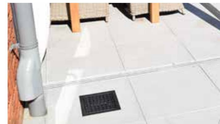
De Zandvangput met grafiet rooster is netjes weggewerkt in de bestrating. Op de regenpijp ziet u de aangesloten loofscheider.
